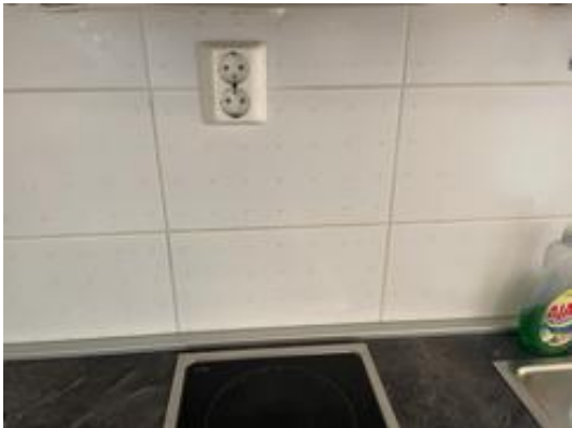
Uheldig plassering av stikkontakt bak platetopp.
