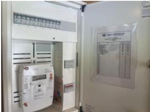
Sikringskap med automat sikringer.
