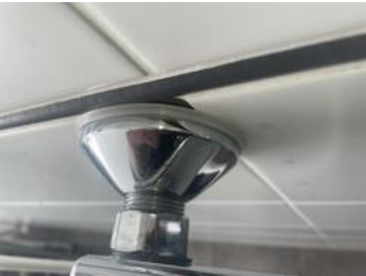
Utette gjennomføringer i flis ved varmt- og kaldtvatn til dusj.
