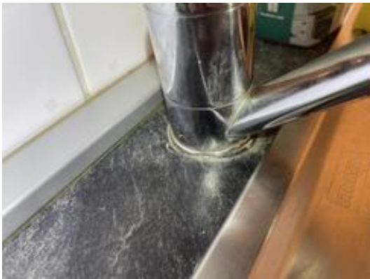
Deformert gjennomføring i benkeplata.
