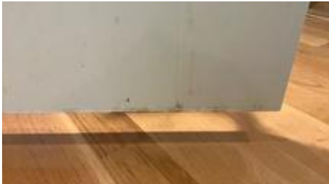
Slitasje på dør til våtrom.
