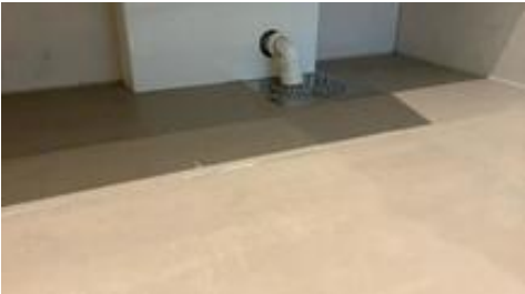
Sluk under innredning.
