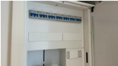
Sikringsskap med automatsikringer.
