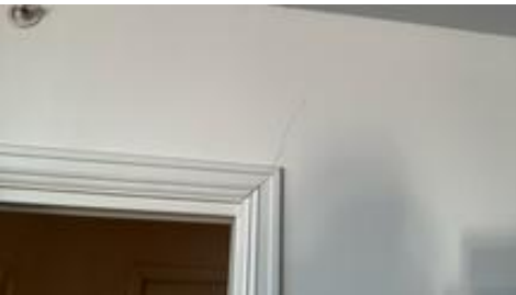
Sprekk over dør.
