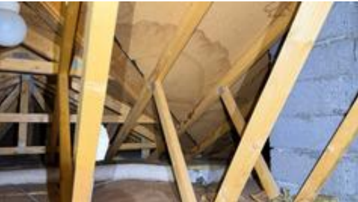
Bilde viser område hvor det er oppdaget eldre fuktmerker på undertak.
