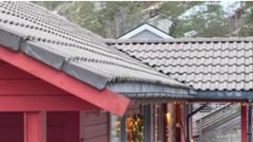
Bilde viser skjevheter i takkonstruksjonen.
