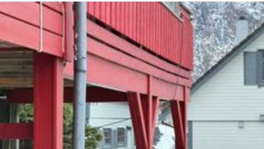
Bilde viser skjevheter/nedbøyninger og sig i konstruksjonen
