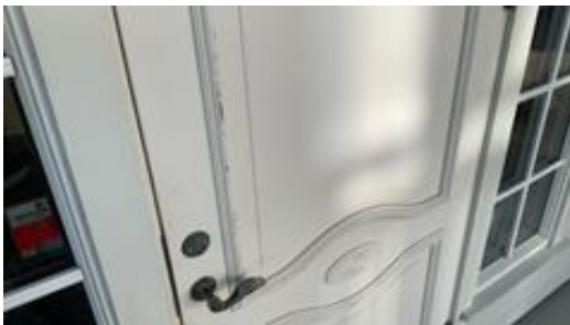
Malingsavflassing på hovedytterdør.
