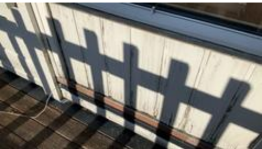
Råteskader på brystning balkongdør.
