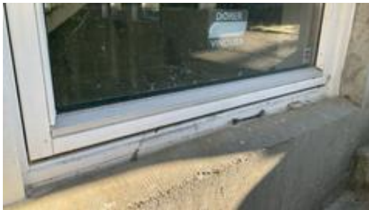
Værslitte vinduer, her i kjeller/mur.
