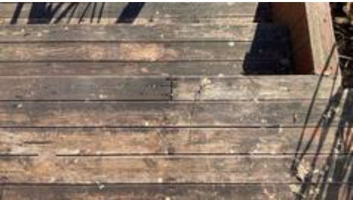
Værslitte terrassebord, enkelte med begynnende råteskader.
