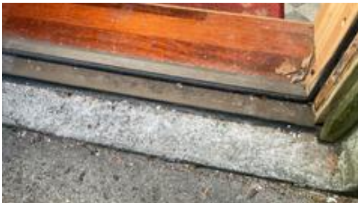
Mangelfull innpusning/beslag under kjellerytterdør.
