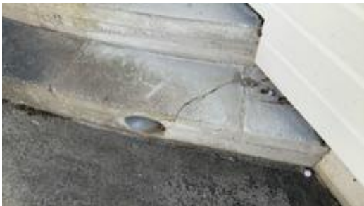
Sprikk i trinn hovedtrapp.
