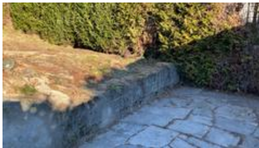
Forstøtningsmur uten rekkverk/fallsikring.
