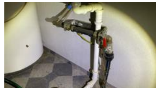
Stengekran på vann
