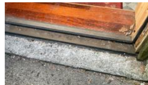
Mangelfull innpussing/beslag under kjellerytterdør.
