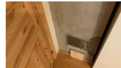
Feiluke kommer for nær brennbart materiale, sprikk i overflate pipe.
