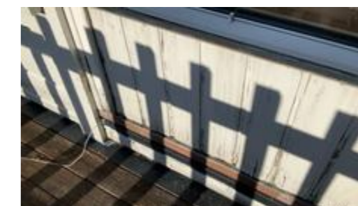
Råteskader på brystning balkongdør.
