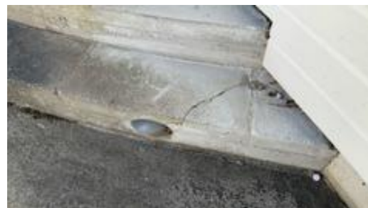
Sprikk i trinn hovedtrapp.
