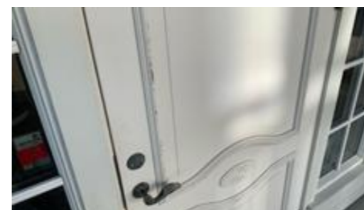
Malingsavflassing på hovedytterdør.
