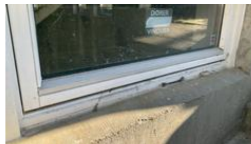
Værslitte vinduer, her i kjeller/mur.
