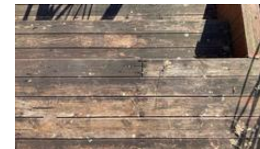
Værslitte terrassebord, enkelte med begynnende råteskader.
