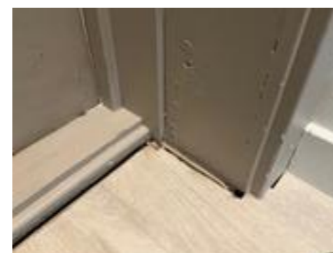
Litt gliper i overgang gulv vegg er observert.
