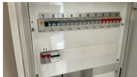
Sikringsskap med automatsikringer.
