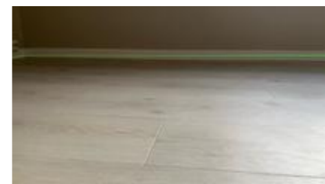
Skjevhet i gulv i stue.
