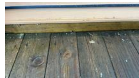
Terskel på balkongdør ikke korrekt utført.
