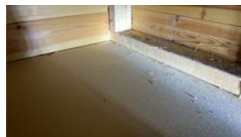
Det er registrert spor av borebiller i konstruksjonen.
