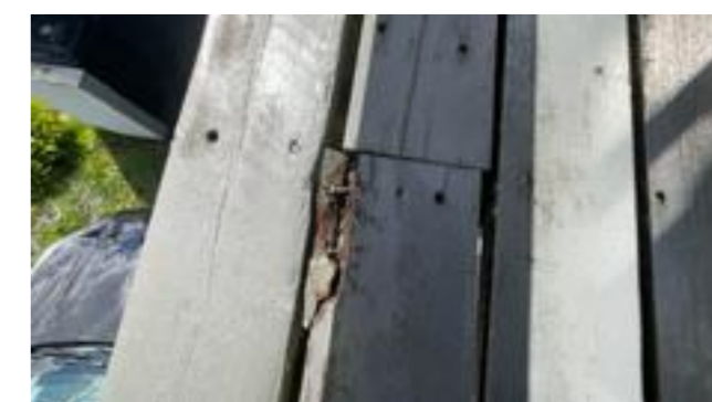
Råteskade på verandaen.
