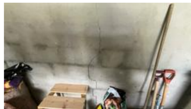
Sprekk i bakvegg.
