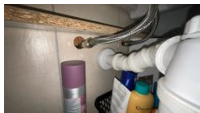
Utett rørgjennomføring i vegg under vask.
