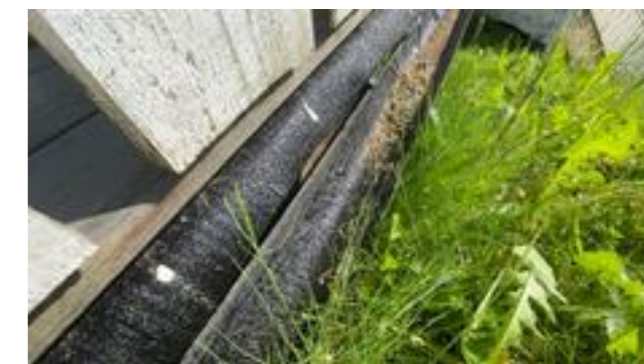
Det mangler beslag i overgang tekkingen på verandaen og ned mot takrennen.
