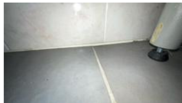
Slitt og sprukket silikonfuge.
