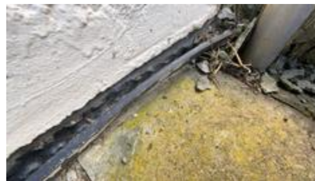
Overgangslist har løsnet.
