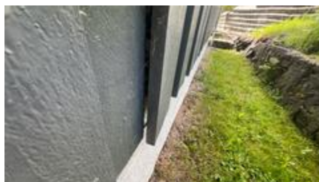
Kledningsbord ligger ikke helt inn til veggen.
