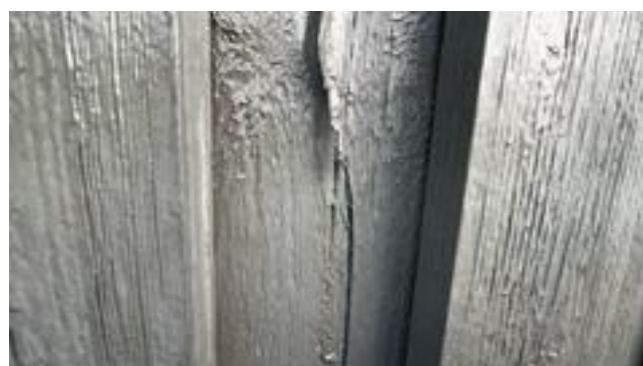
Sprekker i kledning.
