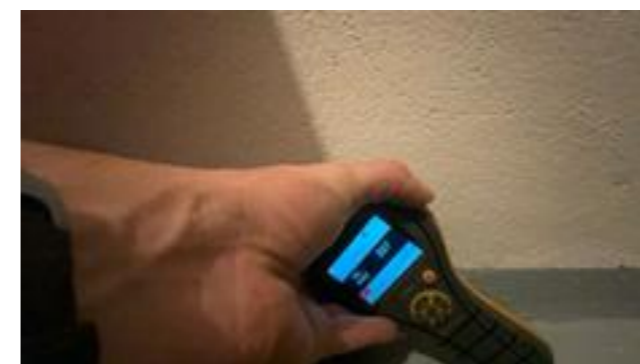
Overflatesøk gir utslag på fukt.
