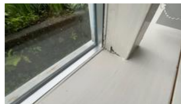
Innvendig merke i karmen på vinduet.
