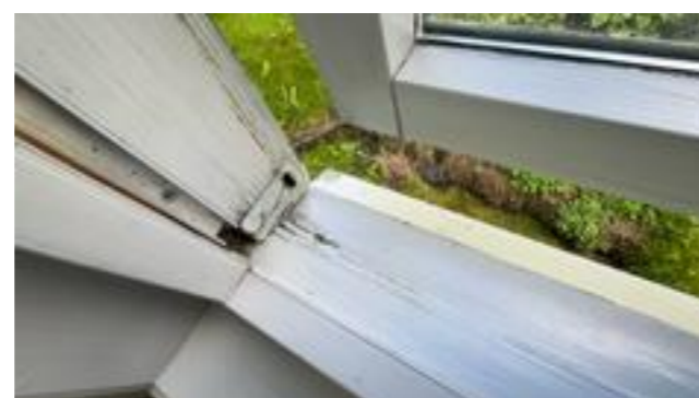
Vinduet på soverom i hovedetasje subber mot karm og er noe værslitt.
