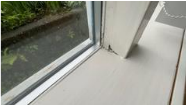
Innvendig merke i karmen på vinduet.
