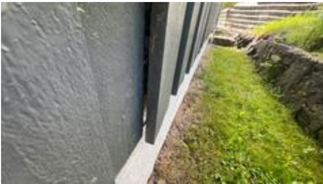
Kledningsbord ligger ikke helt inn til veggen.
