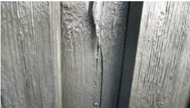
Sprekker i kledning.
