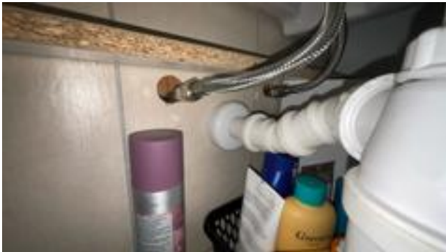
Utett rørgjennomføring i vegg under vask.
