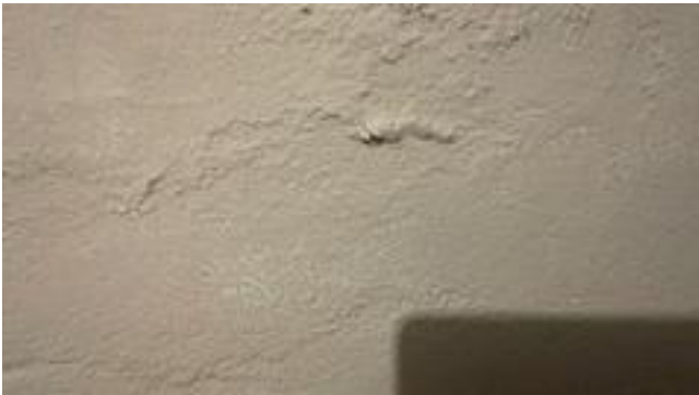
Tegn til saltutslag.
