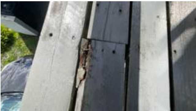
Råteskade på verandaen.
