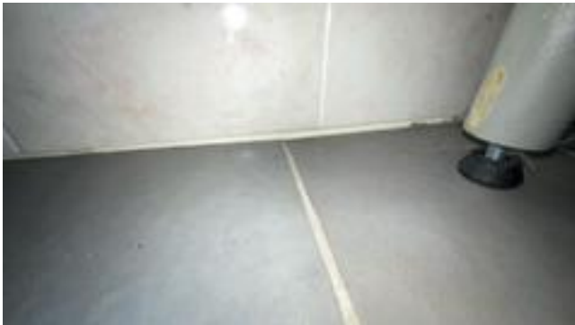
Slitt og sprukket silikonfuge.
