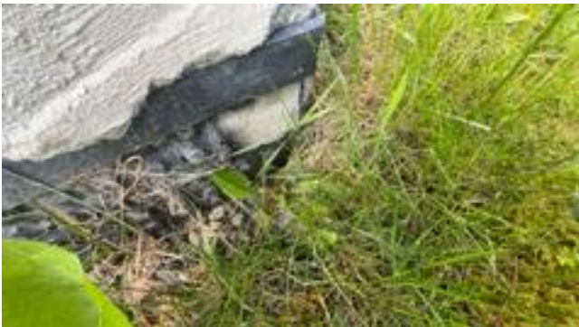
Hull i fuktsperren.
