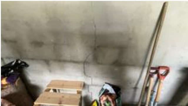
Sprekk i bakvegg.
