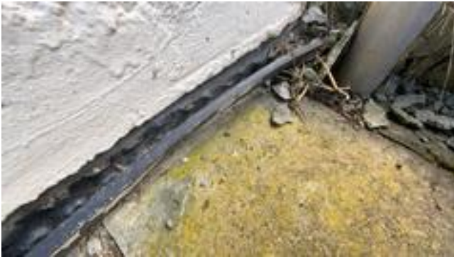
Overgangslist har løsnet.
