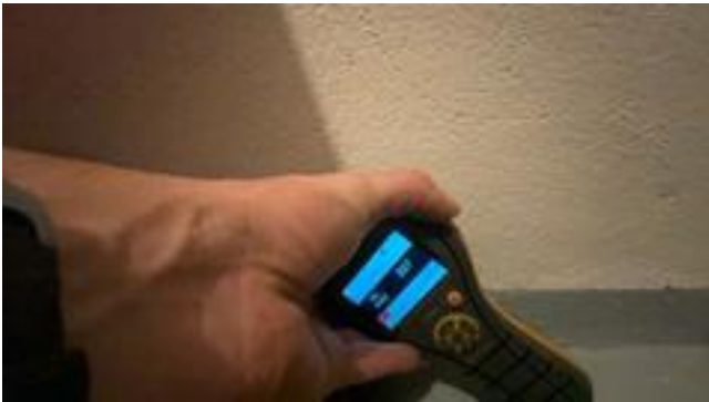
Overflatesøk gir utslag på fukt.
