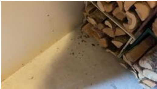
Rotteskit på gulv.
