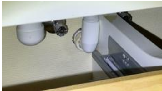
Rørgjennomføring i vegg under vask.
