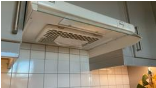
Ventilator funksjonstestet med papir.
