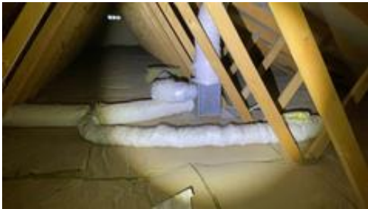
Motor fra ventilasjonsanlegget.
