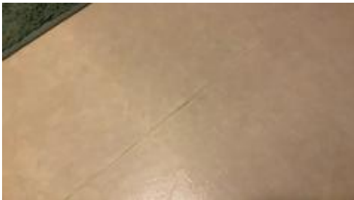
Sprikk i sveiseskjøt.
