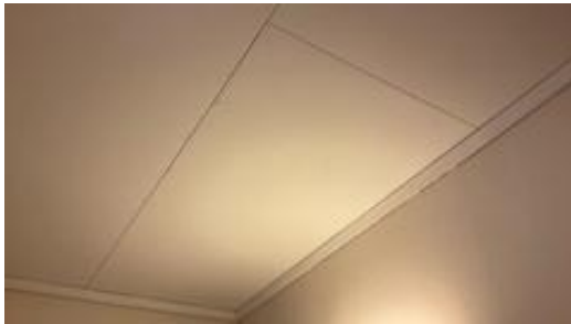
Fuktskader/sprikk på takplater.
