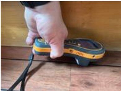
fuktutslag i gulv ved innredning
