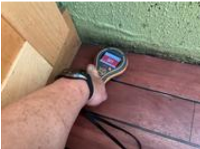
Fuktutslag i gulv.
