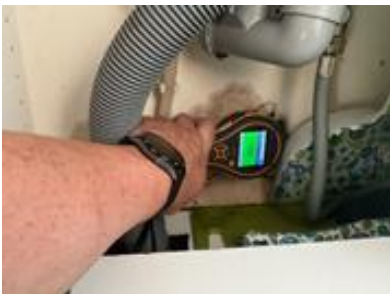
Fuktskjolde i vegg.
