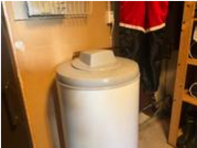
Varmtvannstank for hovedbolig.
