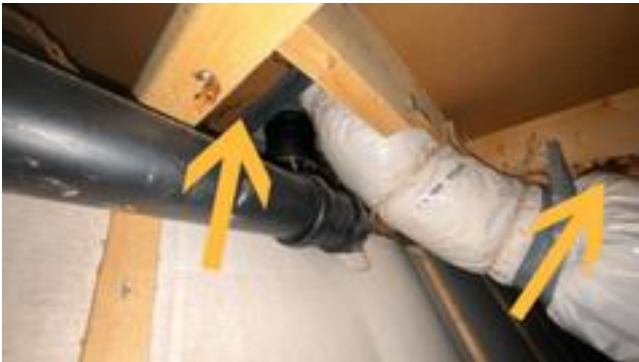
Fuktskjolder opp under taket.
