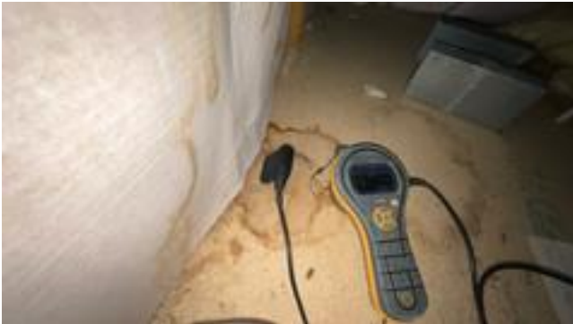
Fuktskjolder på gulvet i kott.
