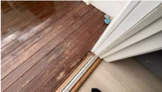
Noe værslitt skyvedør.
