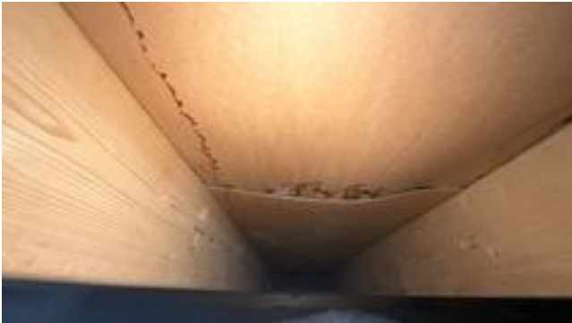
Fuktskjolder opp under Sutakplate.
