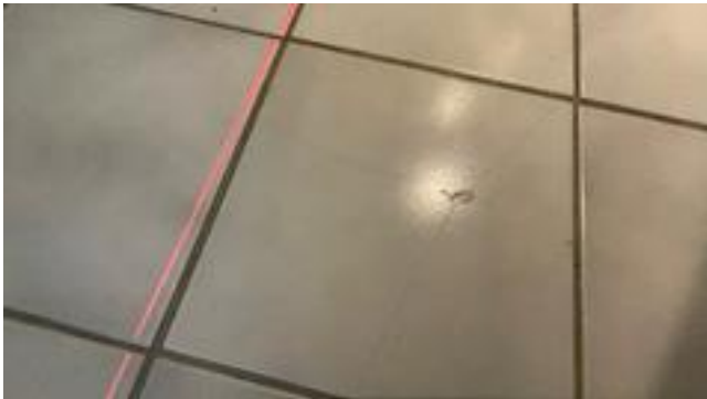
Hakk og sprekk i flis.
