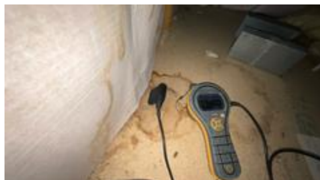
Fuktskjolder på gulvet i kott.
