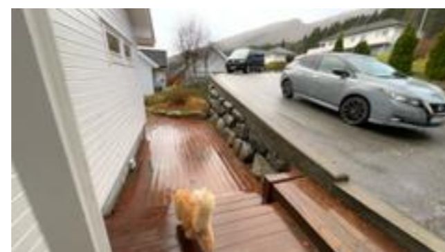
Støttemur mangler rekkverk.
