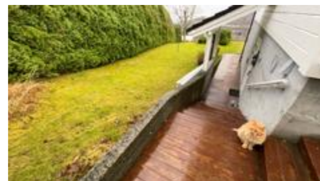
Støttemur mangler rekkverk.
