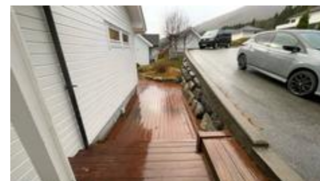
Det er ikke kjenskap til hvordan terrenget er under terrassen.
