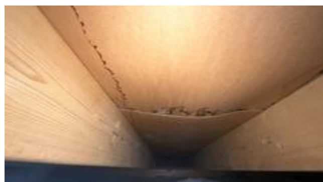
Fuktskjolder opp under Sutakplate.
