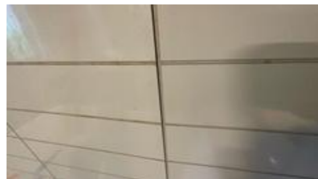
Baderomsplatene er ikke helt tette i skjøtene, men er fuget.
