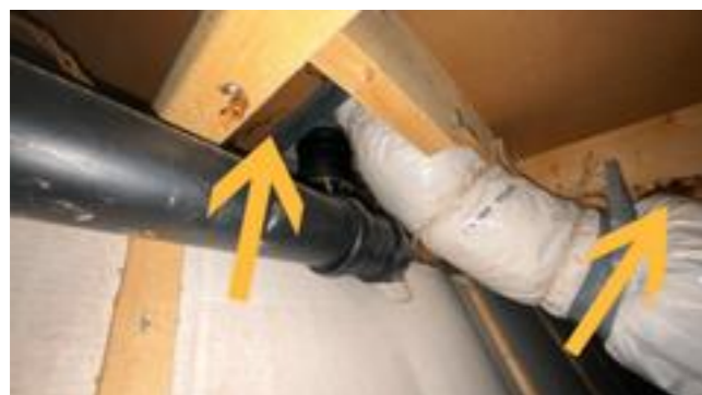
Fuktskjolder opp under taket.
