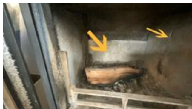
Sprekk i ildfast stein.
