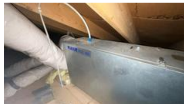
Ventilasjonsaggregatet er defekt.
