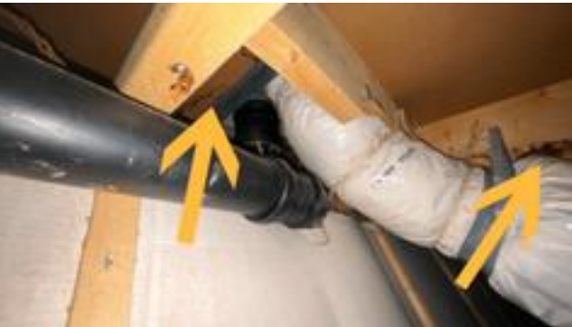
Fuktskjolder opp under taket.
