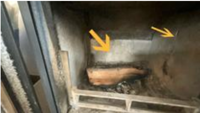
Sprekk i ildfast stein.
