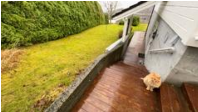
Støttemur mangler rekkverk.
