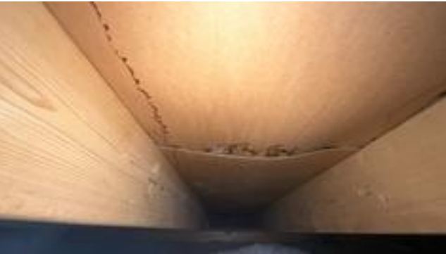
Fuktskjolder opp under Sutakplate.
