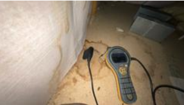
Fuktskjolder på gulvet i kott.
