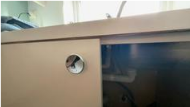
Benkeplaten sveller litt.
