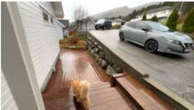
Støttemur mangler rekkverk.
