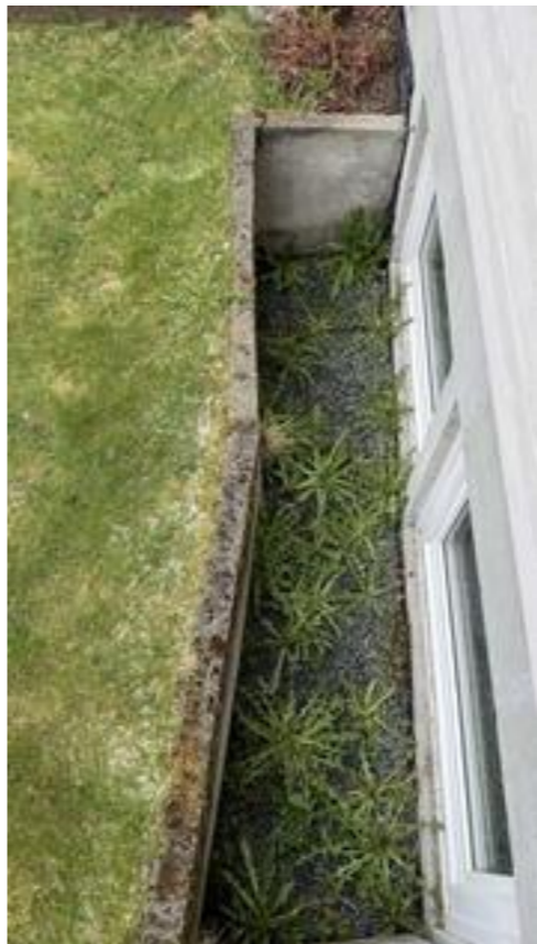
Eksempelbilde av sprekke/ skjevhet i lysgrav.
