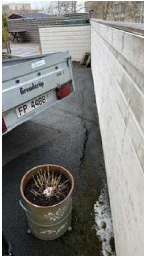
Eksempelbilde av sprekke/ utglidning av asfalt.
