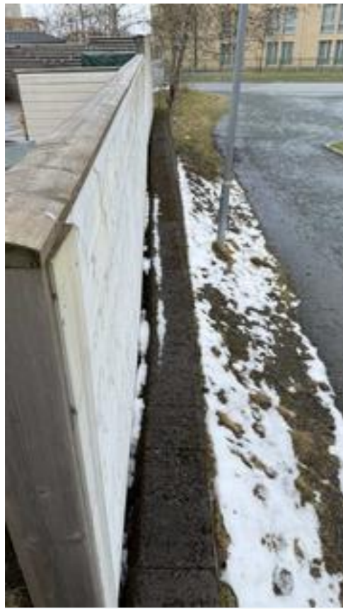
Eksempelbilde av skjevhet i støttemur mot nord.
