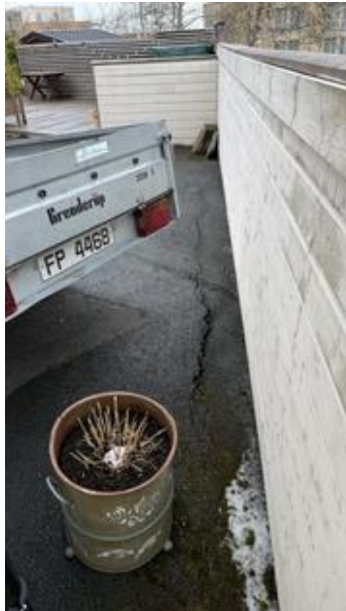
Eksempelbilde av sprekk/ utglidning av asfalt.
