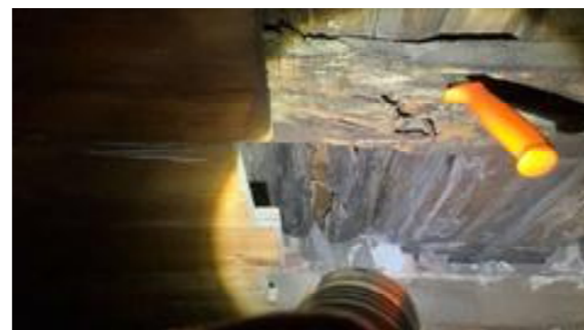
Parti av underkledning som er rått.
