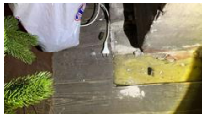
Avføring fra skadedyr.
