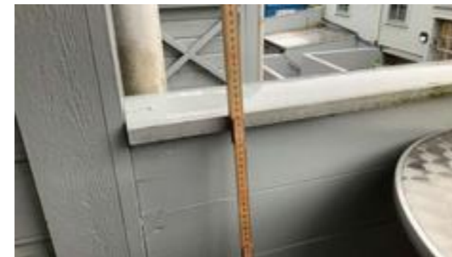
Rekkverk på balkong er lavere enn 90 cm.
