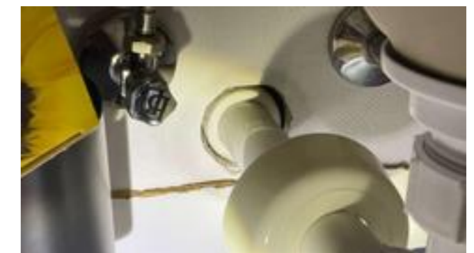
Ikke fukttett rørgjennomføring i vegg under vask.
