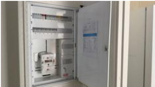
Bildet viser sikringsskapet for det elektriske anlegget.
