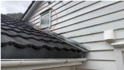
Bilde viser råteskader i vindu på loft.
