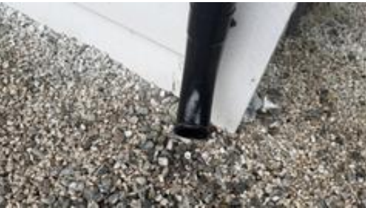
Bilde viser eksempel på at taknedløp er avsluttet over bakkenivå og ikke ledet videre bort fra boligen/fundament.
