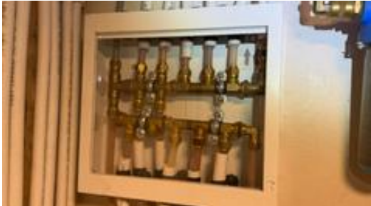
Bildet viser fordelerskap for vannledninger. Det anbefales en årlig kontroll for å se etter eventuelle lekkasjer og korrosjoner.
