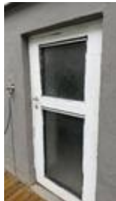
Bilde viser eldre kjellerdør med behov for utskifting.
