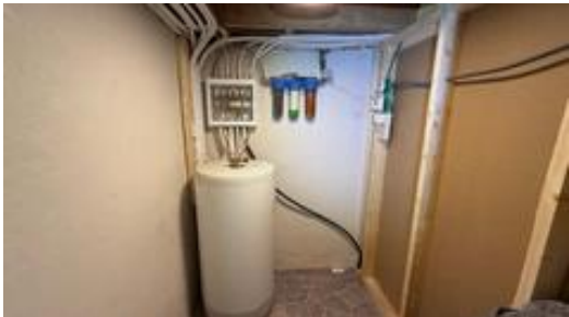
Oversiktsbilde av vanninstallasjonen. Det er etablert vannfilter på inntaket. Det er også montert automatisk lekkasjestopper som stenger vannet ved deteksjon av vann.
