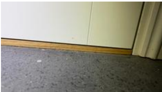
Bilde viser at det mangler luftespalte i dørstokk til baderommet.
