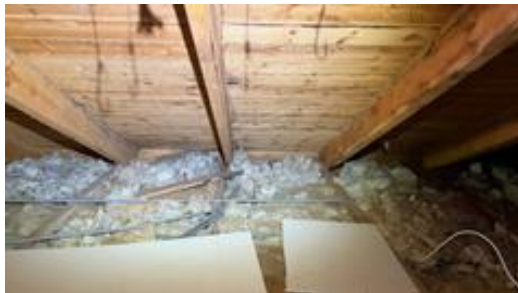
Bilde viser deler av kaldtloft, her med manglende luftespalte i den nedre delen (raftet).
