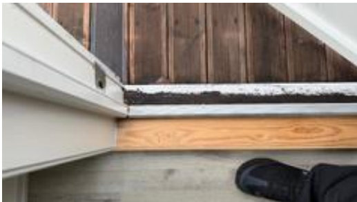
Bilde viser fuktskade i dørstokk på altandør.
