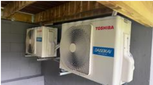
Bilde viser utdelene til varmepumper. Den fremste er fra 2025 i følge eier.
