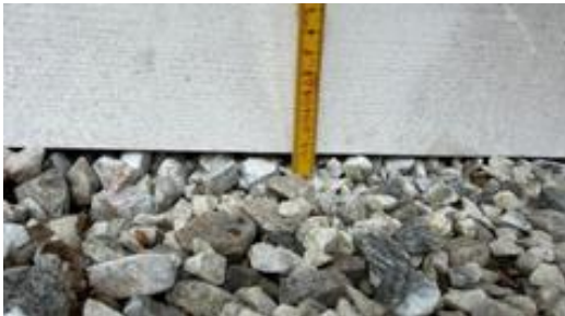
Bilde viser at det mangler avstand mellom bordkledning og bakkenivå.
