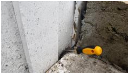
Bilde viser eksempel på stedvis råteskader i bordkledning.
