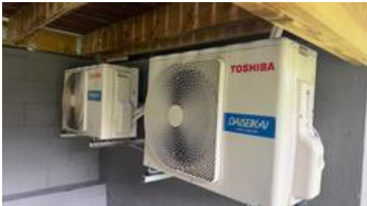
Bilde viser utedelene til varmepumper. Den fremste er fra 2025 i følge eier.
