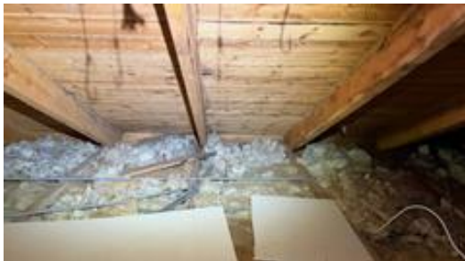
Bilde viser deler av kaldtloft, her med manglende luftespalte i den nedre delen (raftet).
