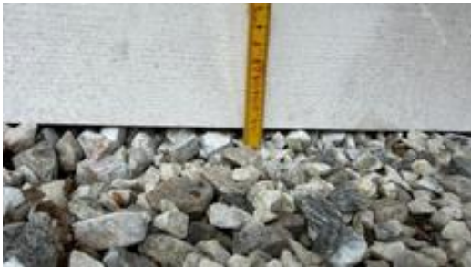
Bilde viser at det mangler avstand mellom bordkledning og bakkenivå.
