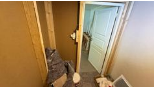
Bilde viser eksempel på gjenstående arbeider i underetasjen.
