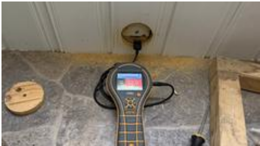
Bilde viser fuktmåling i påforet vegg mot terreng.
