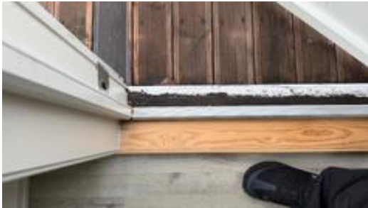
Bilde viser fuktskade i dørstokk på altandør.
