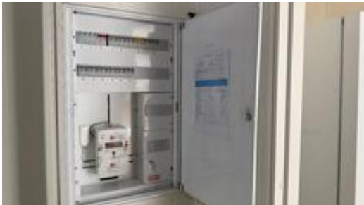
Bildet viser sikringsskapet for det elektriske anlegget.
