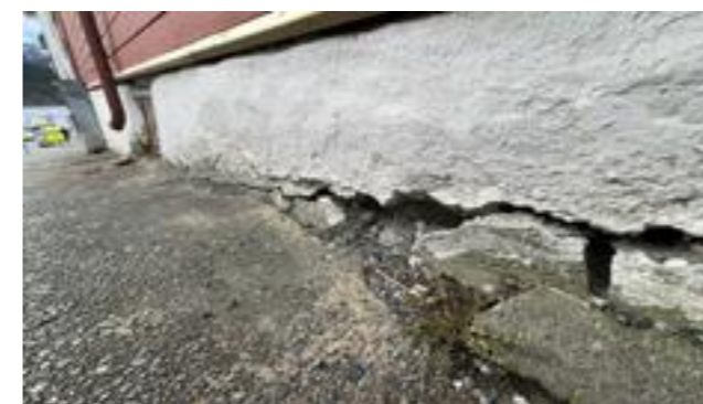
Eksempel på på sprekker
