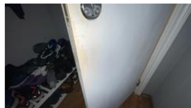
Eksempel på slitasje.
