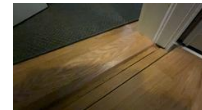
Eksempel på slitasje/ avvik
