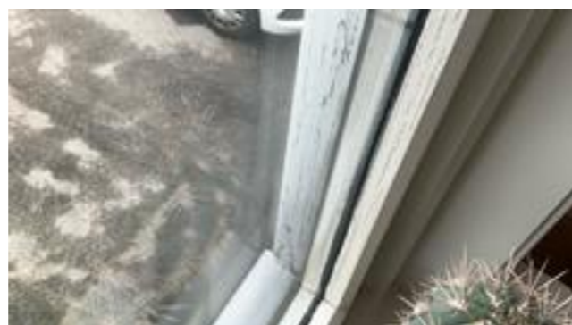
Værslitt vindu. Bildet tatt fra innsiden.
