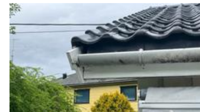
Det er fuktskade og værslitt vindski- og loddbord.
