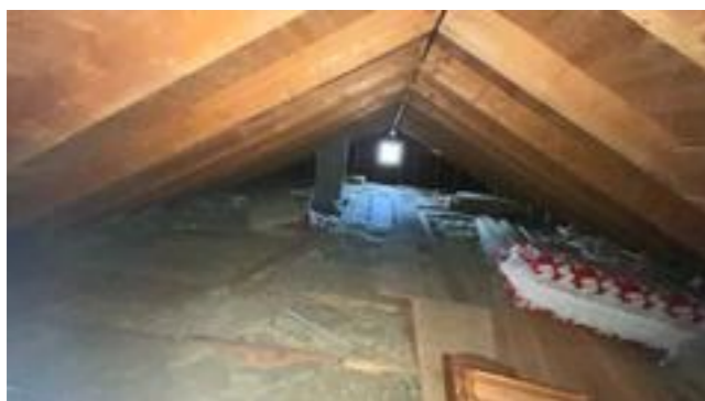
Ventil i gavlvegg, men begrenset lufting andre steder.
