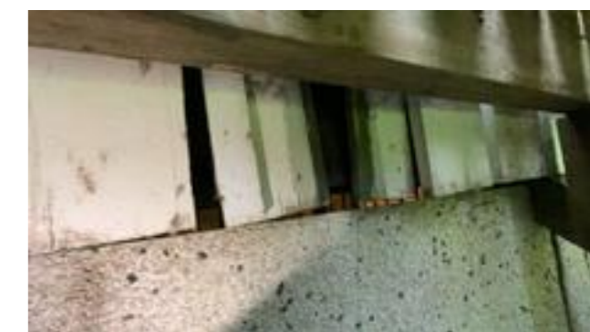
Under verandaen er det løse kledningsbord.
