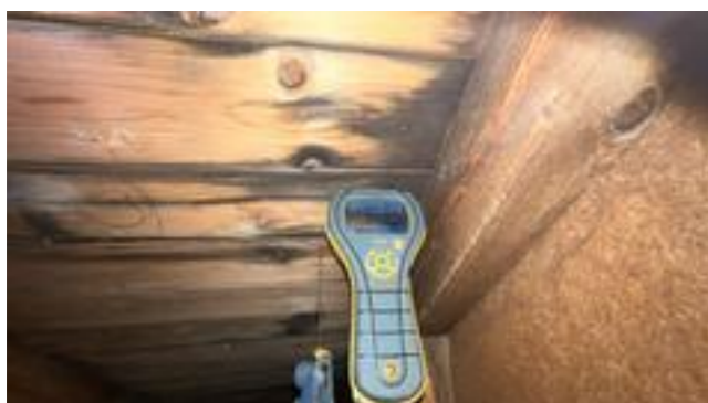
Fuktskjolde som var tørr.
