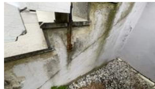
I betongtrappen er det noen skrå riss.
