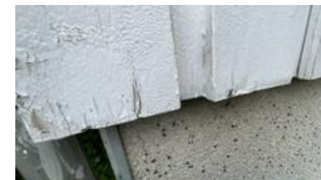
Det er observert råteskader i nedre del av kledningen.
