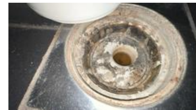
Sluk under baderomsinnredning.
