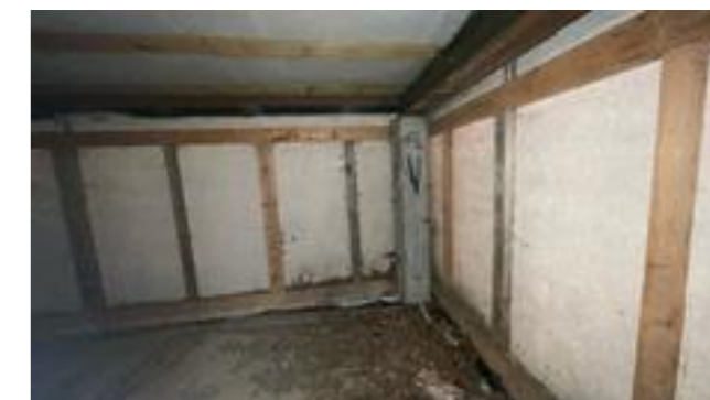
Ventileringen vurderes som ikke tilstrekkelig.
