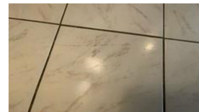
Sprekk i flis.
