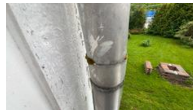
Mose fra skjøt i nedløp.
