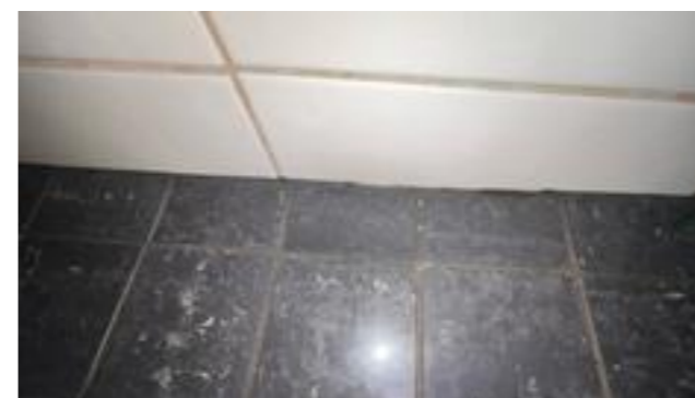
sprekk i silikonfuge
