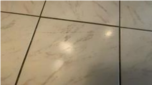
Sprekk i flis.
