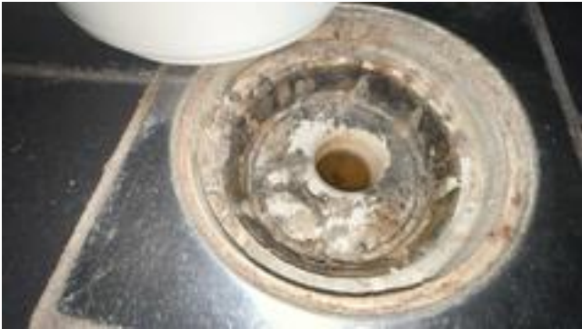
Sluk under baderomsinnredning.
