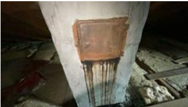
Rennemerker fra feieluken.
