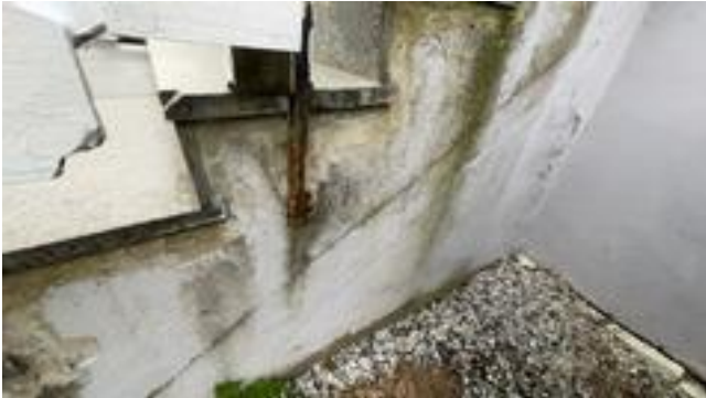
I betongtrappen er det noen skrå riss.
