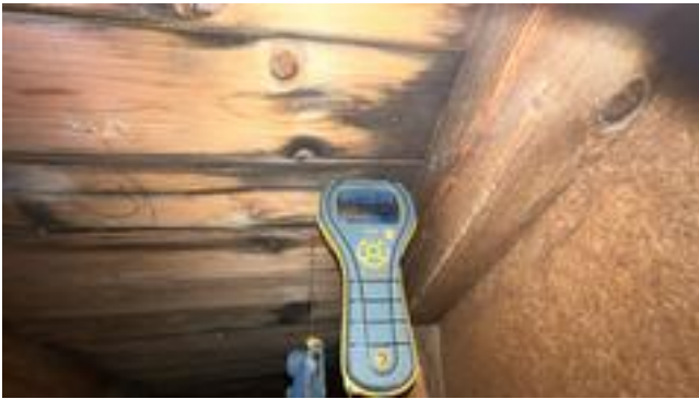
Fuktskjolde som var tørr.
