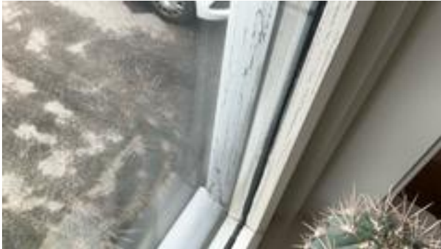
Værslitt vindu. Bildet tatt fra innsiden.
