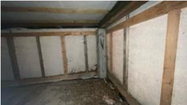
Ventileringen vurderes som ikke tilstrekkelig.
