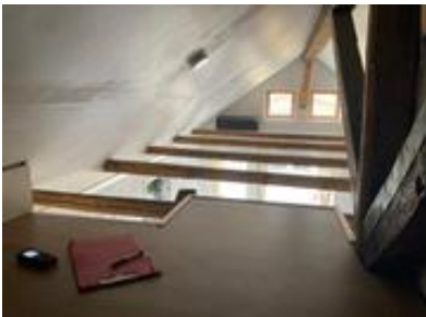
Mangler rekkverk i front
