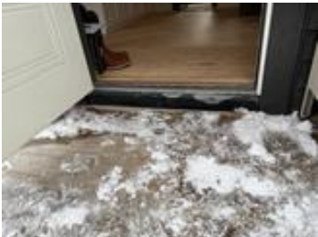
Dårlig/feilmontert terskelbeslag hovedytterdør
