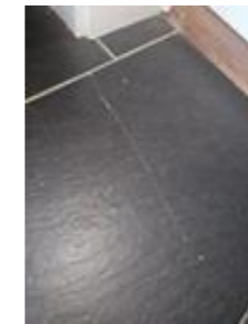
En sprukken gulvflis i gangen
