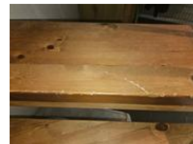
En del slitasje på trappetrinn
