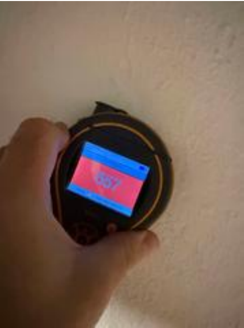
Eksempelbilde av forhøyede fuktverdier.
