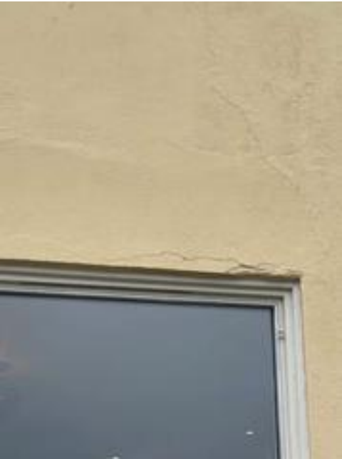
Eksempelbilde av riss/ sprekk.
