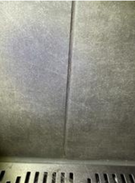
Eksempelbilde av riss/ sprekker i flisfuger.
