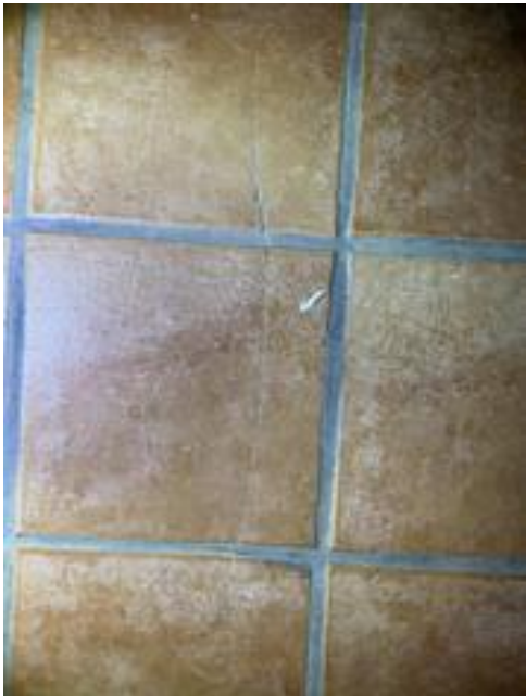
Eksempelbilde av sprekk i gulvflis.
