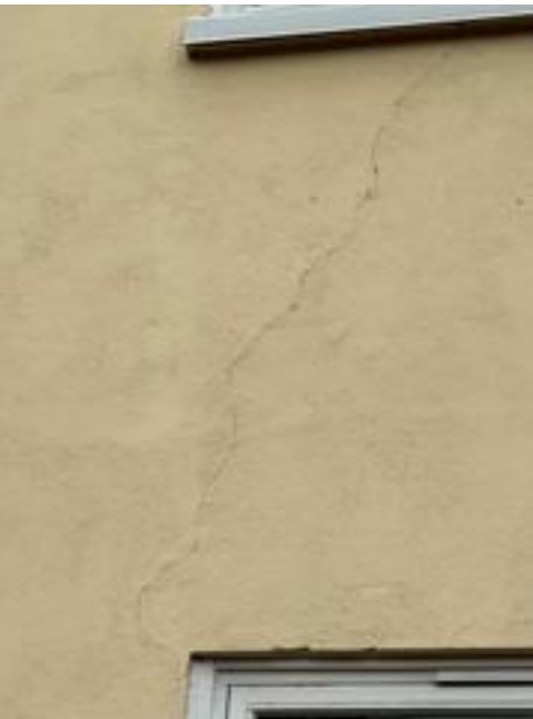
Eksempelbilde av riss/ sprekke.
