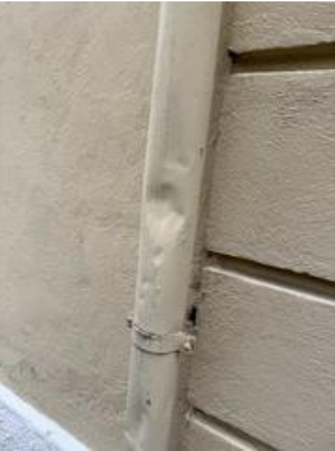
Eksempelbilde av slitasjegrad/ buler.
