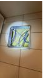
Høyt­taler kabler i inspeksjonsluke i vaskerom.
