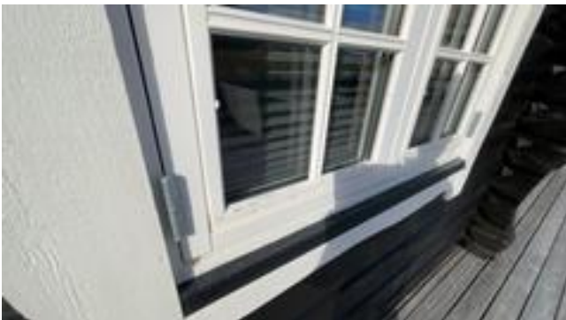
Det er flere vinduer som er værslitte.
