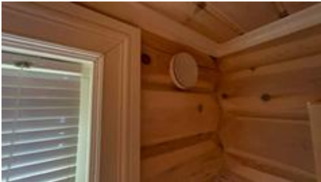
Det er kun naturlig ventil i rommet.
