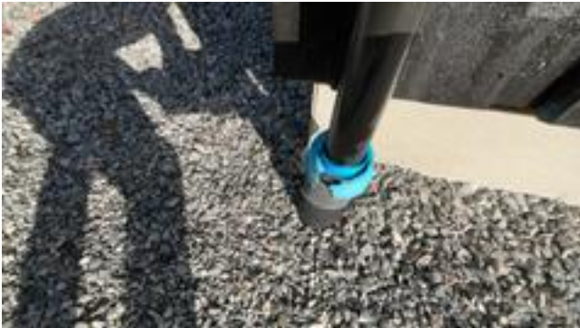
Flere overgangsmuffer er skadet.
