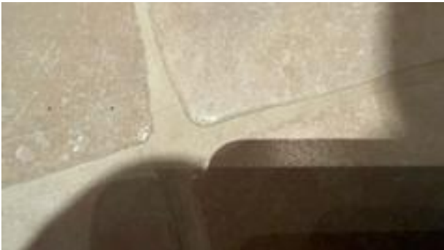
Små riss i flisfuger.
