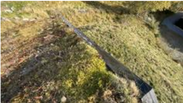
Værslitt toppbord over vindski.
