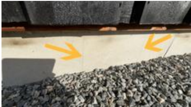
Riss i grunnmurselement.
