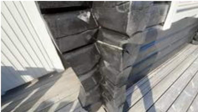
Sprekker i tømmeret må mettes.
