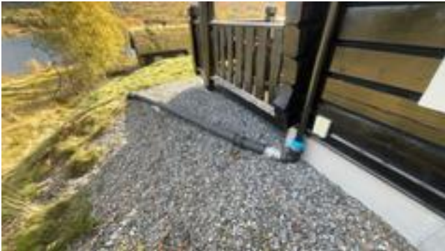
Rør som ligger over grunn.
