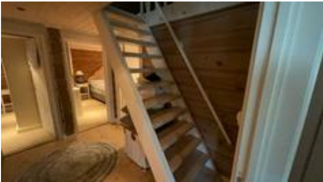
Trappen mangler rekkverk.
