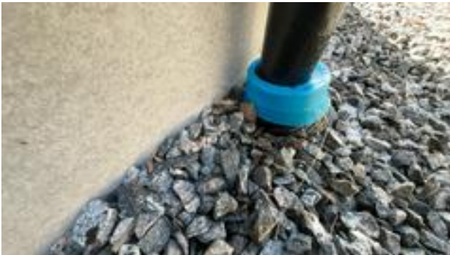
Nedløp treffer litt skjevt inn på rør som går ned i grunn.
