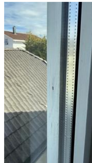
Eksempelbilde av påbegynt værslitasje/ malingsavflass.
