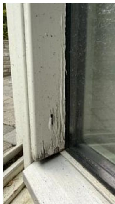
Eksempelbilde av værslitasje/ malingsavflass.
