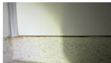
Eksempelbilde av misfarging og åpninger/sprekker i fugemasse i bunnlist til våtromsplater.
