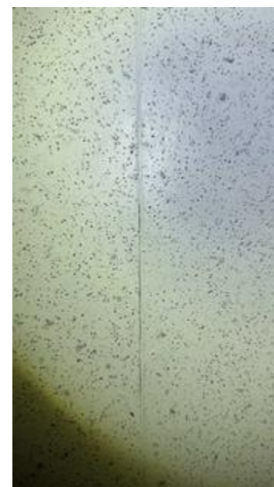
Eksempelbilde av glippe/ sprekk i skjøt til gulvbelegg.
