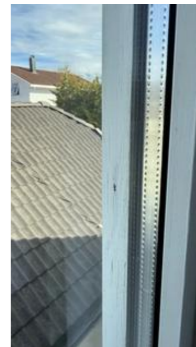
Eksempelbilde av påbegynt værslitasje/ malingsavflass.
