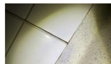
Eksempelbilde av glippe og svelling/ fuktskade i våtromsplater i dusjsone.
