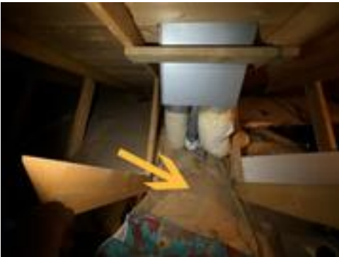
Fuktskjolde på isolasjon.
