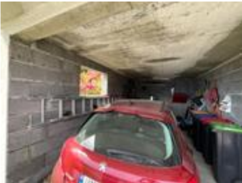
Fra garasjen er det saltutslag i taket opp under verandaen.
