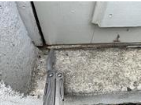
Mykt trevirke i nedre del av karmen, som er et tegn på påbegynnende råteskade.
