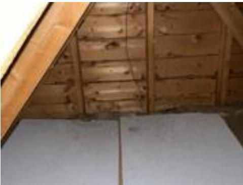
Fuktmåling på innsiden av gavlvegg. Ikke unormalt utslag.
