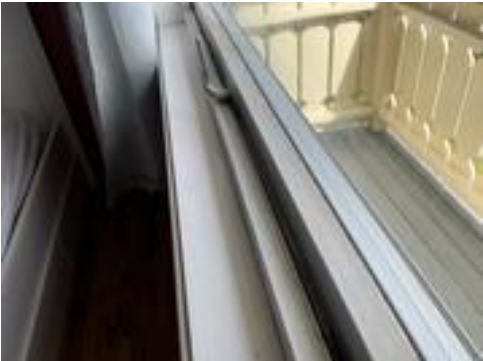
Vinduet er skjevt og subber mot karm.
