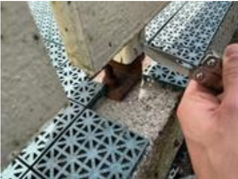
Tendenser til råteskade i rekkverk og rust på innfestning.
