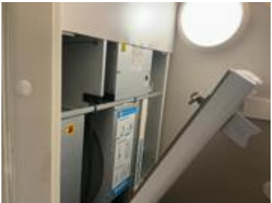
Balansert ventilasjon med varmegjenvinner
