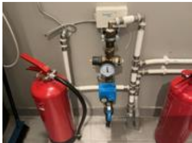
Stoppekran og reduksjonsventil for vann
