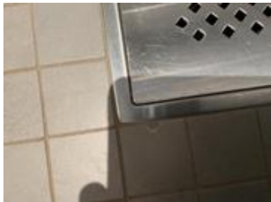
Liten skade i glasuren på en gulvflis
