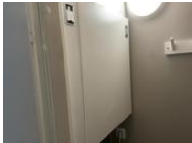
Balansert ventilasjon med varmegjenvinner
