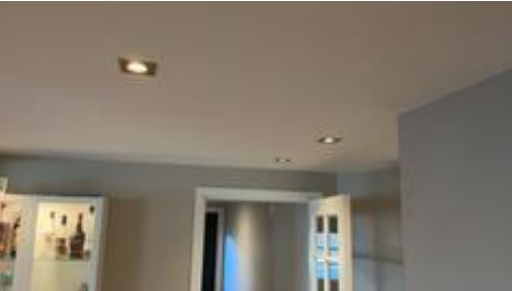
Spotter i takhimling i gang pulserer og bør sjekkes av elektriker.
