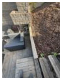
Støttemur med mindre skjevheter
