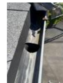
Hull i takrenne(Mot Kyrre Grepps vei)
