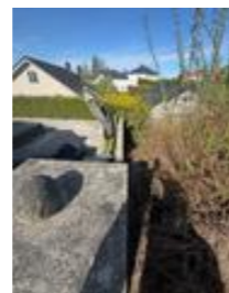
Støttemur med mindre skjevheter
