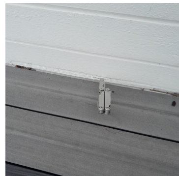
Overgang mellom klædning og veranda.
