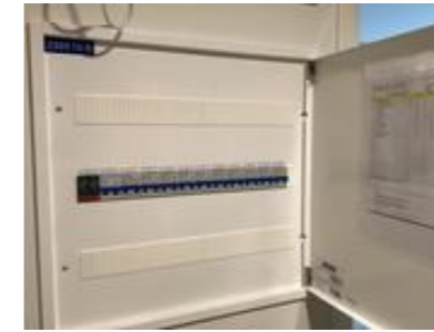
Bilde av sikringskap.
