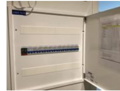
Bilde av sikringskap.
