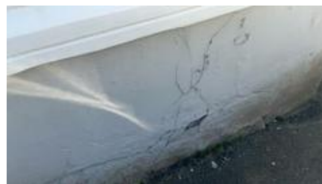
Sprekker i murpuss.
