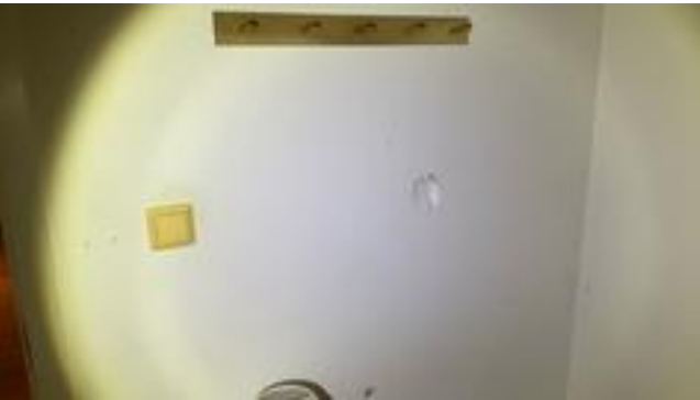
Skade i vegg.
