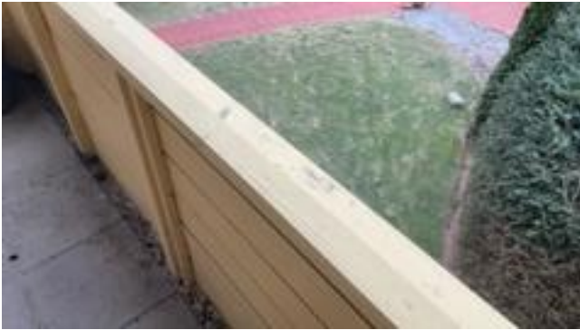
Malingsavflassing på overflater rekkverk/rekke.
