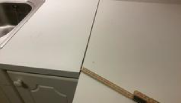
Ufagmessig/ugjevn skjøt på benkeplate
