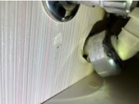
Ikke fukttett rørgjennomføring i vegg.
