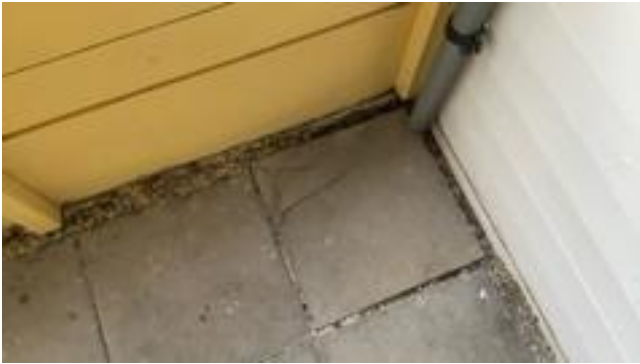
Sprikk i betonghelle.
