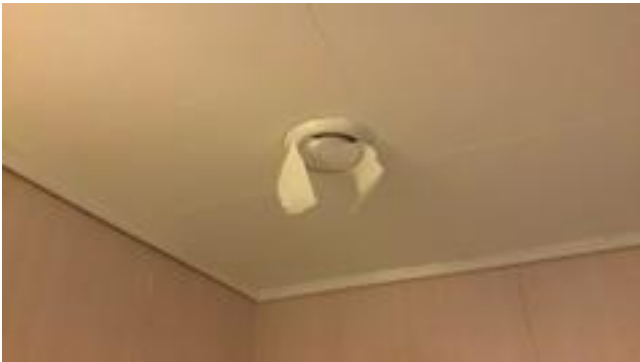
Avtrekk funksjonstestet med papir.
