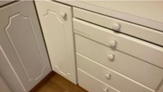
Bruksslitasjer/merker på enkelte dører/fronter.
