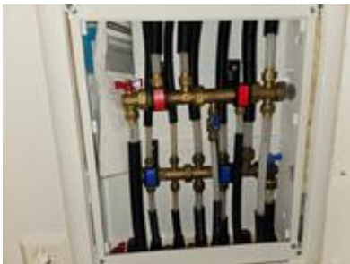
Fordelingsskap for tappevann, kjeller.
