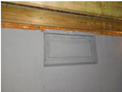
Tettet mellom grunnmur og yttervegg med fugesku
