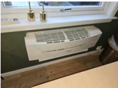
Luft til luft varmepumpe i 1 etg
