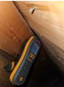
Forhøyet fuktinnhold i undertaket ved oppløftet
