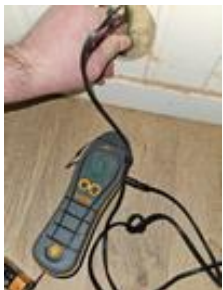
Målt med moltstandsmåler i yttervegg under terrenget, 17,1 %
