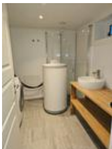
Oversiktsbilde bad / vaskerom. Varmtvannstanken flyttes, ikke ferdig ved befaring
