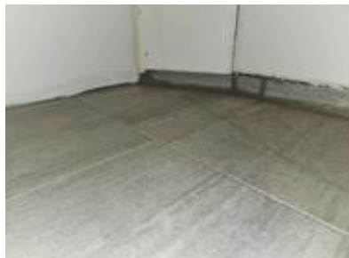
Ikke fagmessig overgang gulv / vegg i deler av rommet
