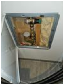
Stoppekran, reduksjonsventil og måler for vann
