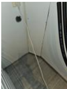
Ikke fagmessig utførte badreomsplater i deler av rommet
