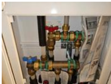
Fordelingsskap for tappevann, på loftet
