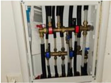
Fordelingsskap for tappevann, kjeller.
