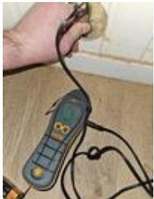
Målt med moltstandsmåler i yttervegg under terrenget, 17,1 %
