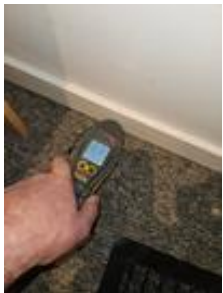
Ikke unormalt utslag ved søk med fuktindikator på gulvet i gangen
