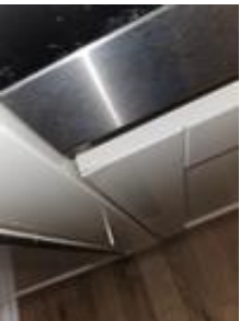
Sprekk i øvre kant av en skapdør
