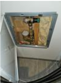
Stoppekran, reduksjonsventil og måler for vann
