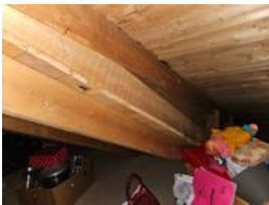
Fuktmerke på undertaket ved oppløft mot vest
