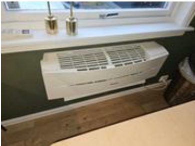
Luft til luft varmepumpe i 1 etg
