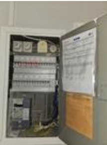
Sikringsskap med automatsikringer og kursfortegnelse
