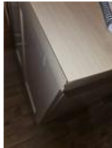
Skade på kanten på en benkeplate
