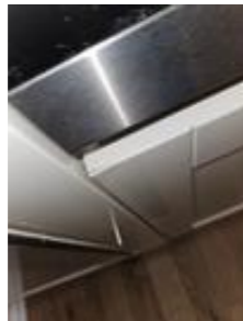
Sprekk i øvre kant av en skapdør 1 ETASJE > KJØKKEN
