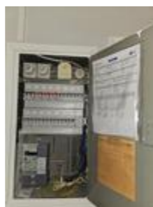
Sikringsskap med automatsikringer og kursfortegnelse
