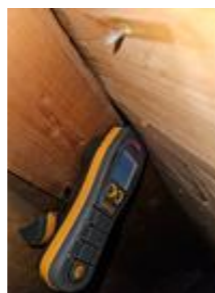
Forhøyet fuktinnhold i undertaket ved oppløftet
