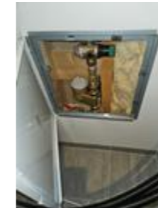
Stoppekran, reduksjonsventil og måler for vann
