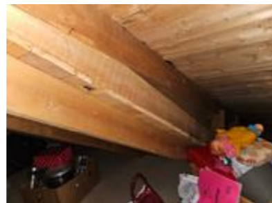
Fuktmerke på undertaket ved oppløft mot vest
