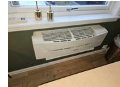
Luft til luft varmepumpe i 1 etg
