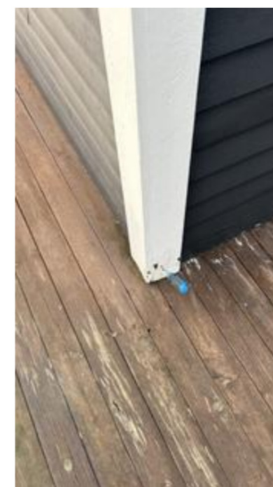
Bildet viser råteskade i hjørnekasse på terrassen ved inngangsdøren.
