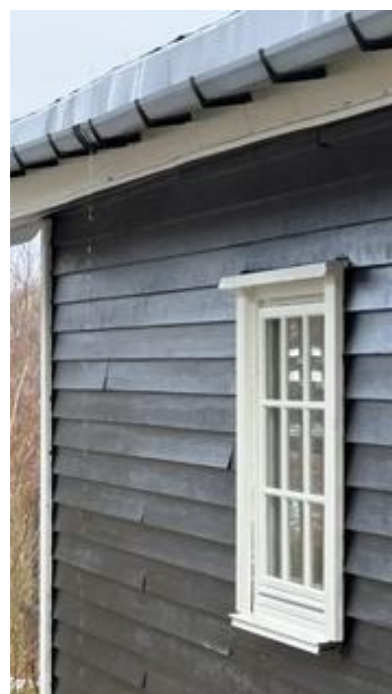
På bildet kan man se lekkasje på skjøt i takrenne.
