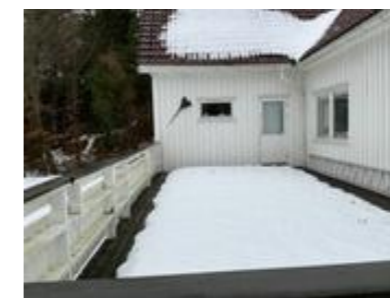
Felles terrasse, ikke kontrollert pga snø.
