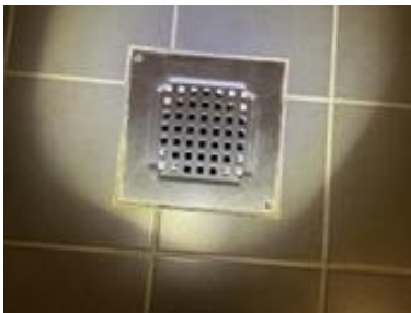
Mindre sprekker i fuger rundt sluk
