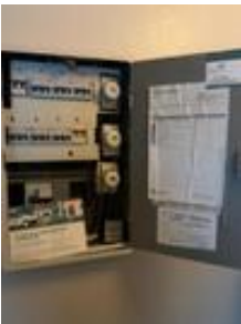
Sikringsskap med automatsikringer og kursfortegnelse
