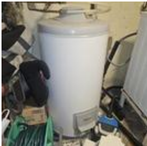
Varmtvannstank i kjelleren
