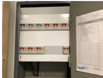
Bilde av sikringskap.
