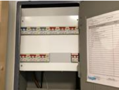
Bilde av sikringskap.
