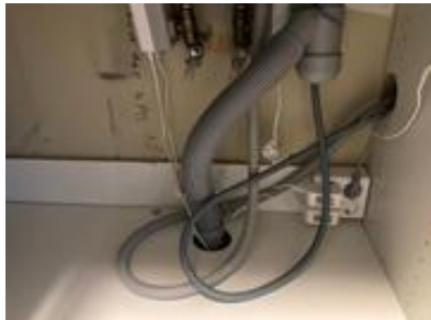
Rørapplegg i skap under vask
